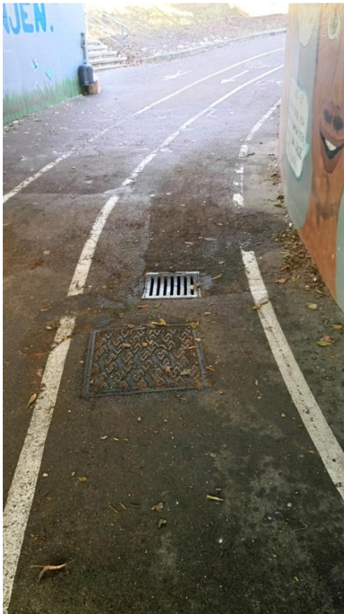
Slika 4: Nepravilno vgrajen odtočni jašek
