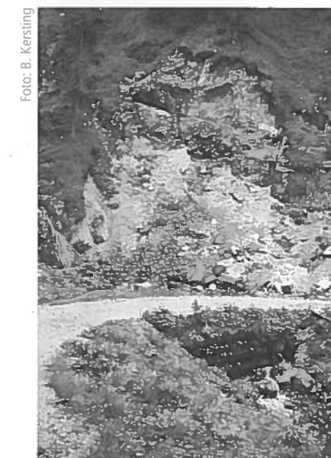
Eden od najhujših gradbenih grehov na gozdarski cesti Mösl
