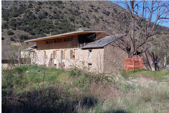
Eden od ciljev projekta MountEE – povečati vrednost starih objektov. © Parc Pyrenees Catalanes
