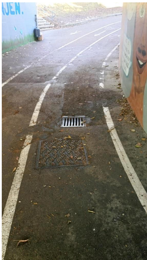
Slika 4: Nepravilno vgrajen odtočni jašek
