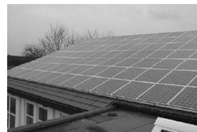
Le Liechtenstein s'engage dans la promotion du photovoltaïque.
