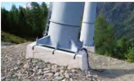
Seitenverschiebbare Seilbahnstütze auf Boden mit Permafrost (Quelle: Bommer et al. 2009)
