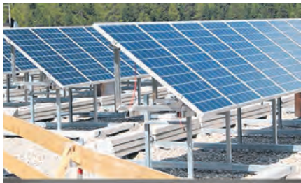
Mit der Solaranlage spart das Hotel Europa in Champfèr-St. Moritz pro Jahr 25`000 Liter Heizöl (Quelle: Hotel Europa o.J.)
