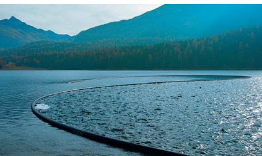
Seewater pipe in front of the anchor on the bottom of the lake. Tubazione dell'acqua lacustre prima dell'ancoraggio sul fondo del lago.
