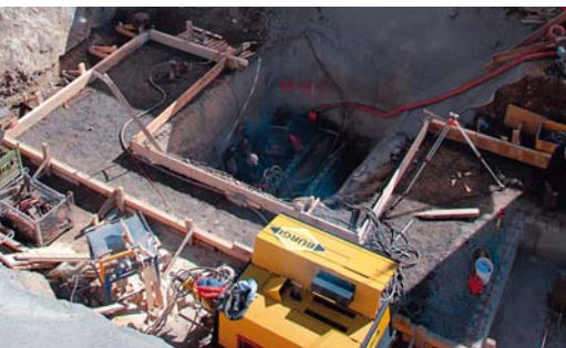
Heat pump center. Centrale del impianto a pompa di calore.
