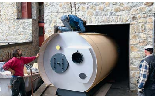
Oil-fired boiler. Le caldaie a olio combustibile.
